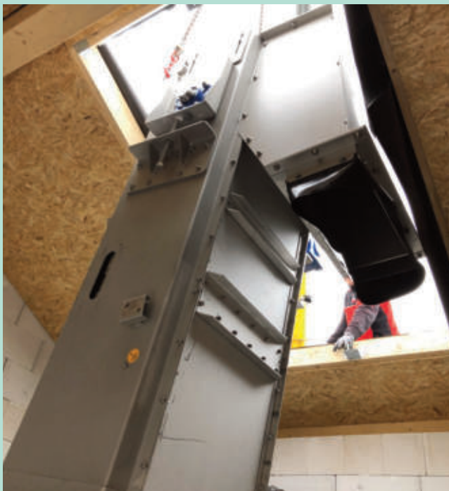
Montage des FSM Hakenumlaufrechens und der FSM Rechengutwaschpresse
