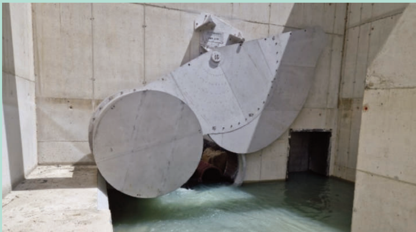
Test (maximale Drosselung) [li] und Betrieb (nicht eingestaut) [re] der Steinhardt HydroSlide® Abflusssteuerung DR 2300 – HRB Rettenbach, Sölden, Tirol
